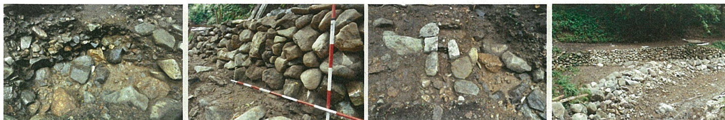
「石組排水溝」や「野面石積み」など金山越の羽州街道では災害復旧時に貴重な遺構が複数検出されました。
